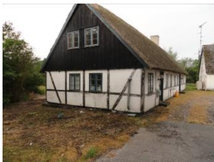
Stuehuset efter mange års manglende vedligeholdelse. Og som det så ud da vi skulle træffe en beslutning af de store
